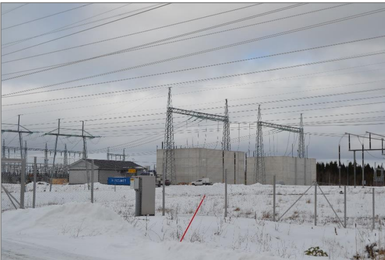
Bild 18. Fingrid Abp:s elstation (objekt 8) fotograferad från sydväst. Kontrollrummet med åstak till vänster färdigställdes 2014.
