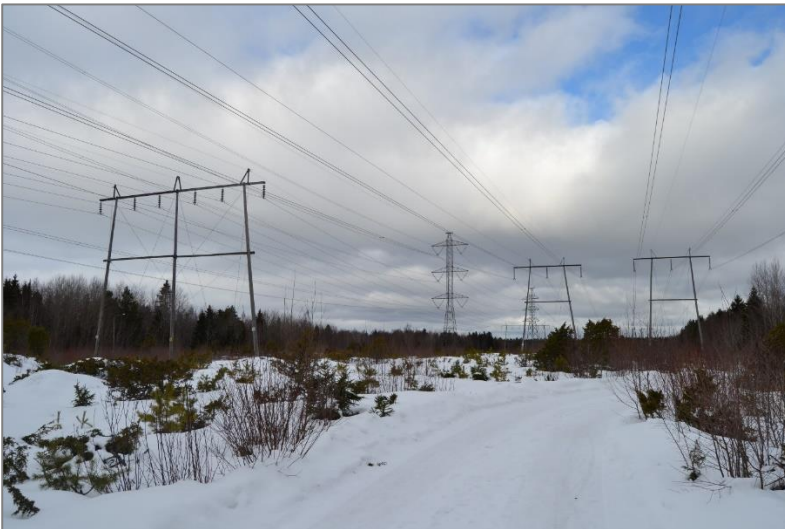
Bild 11. Kraftledningar på elstationens sydvästra sida fotograferat mot nordost.
